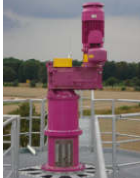
Rührwerksantrieb und -lagerung
