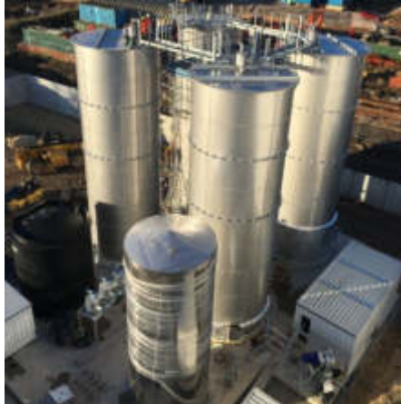
Hydrolysebehälter Hydrolysis tanks
