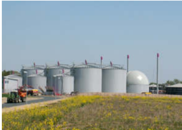
Energiepark Trelder Berg 6 Fermenter mit jeweils 3.860m 3 Trelder Berg Energy Park 6 fermenters, each with a capacity of 3,860 m 3 .
