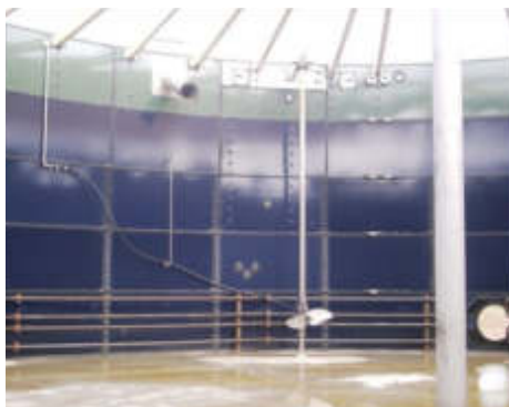
Tauchmotorrührwerk mit seitlicher, gasdichter Bedienungseinrichtung, seitliches Schneckeneintragsystem
