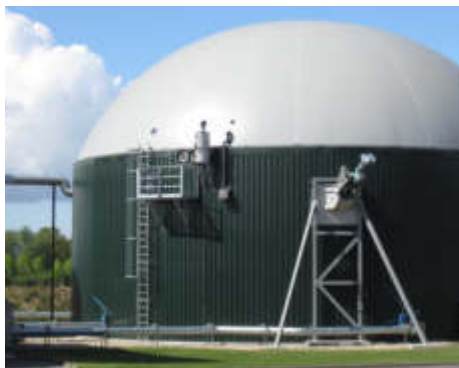
Hydraulische Über- und Unterdrucksicherung
